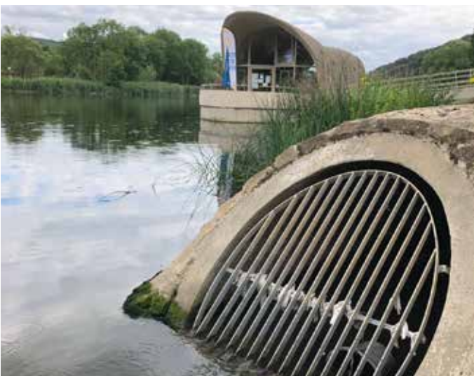
Offensichtliche Abwassereinleitung in die Mosel bei Schengen
